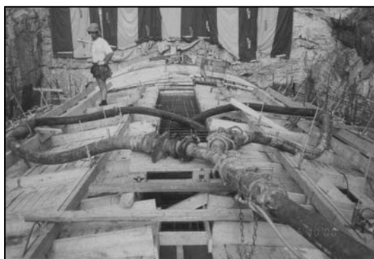
Foto 10. HAC en túneles con acceso exterior.
