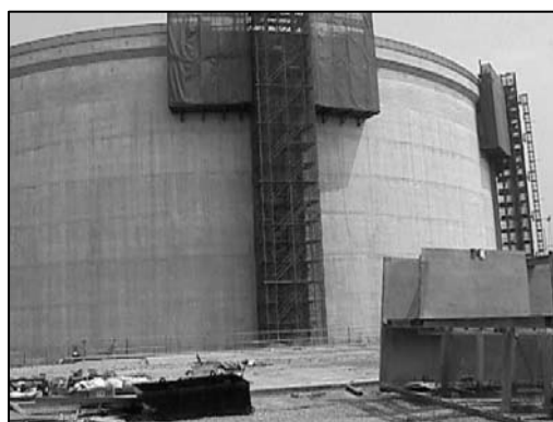
Foto 12. Tanque de gas en Osaka, Japón.
